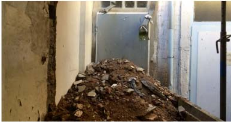
Der Zugang zum Kreativ-Raum und dem Lager der Teestube wurde zugeschüttet. Miete wird dafür, so die Verantwortlichen der Teestube, dennoch fällig.
